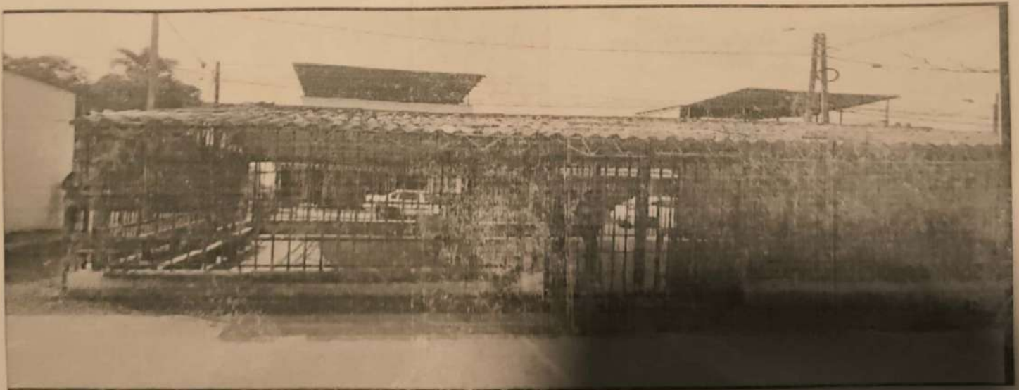
GRECIA 15 MTS LINEALES X 4 DE ALTURA CASETA COMUNAL PARA EVITAR ROMPER TEJAS
